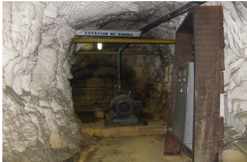
Foto 8.- Bomba Estacionaria en el Nivel -470 de 100 HP
