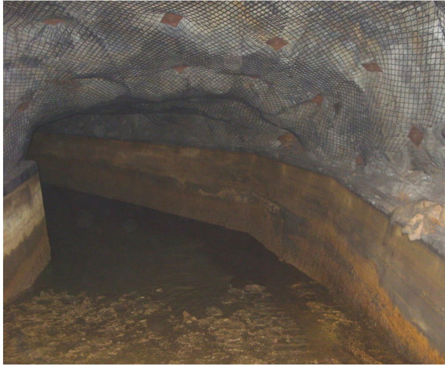
Foto 7.- Ingreso a la tasa de bombeo del Nivel -470
