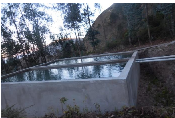
TANQUE DE ALMACENAMIENTO (120 M3)
