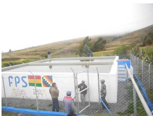
TANQUE DE ALMACENAMIENTO (250 M3)
