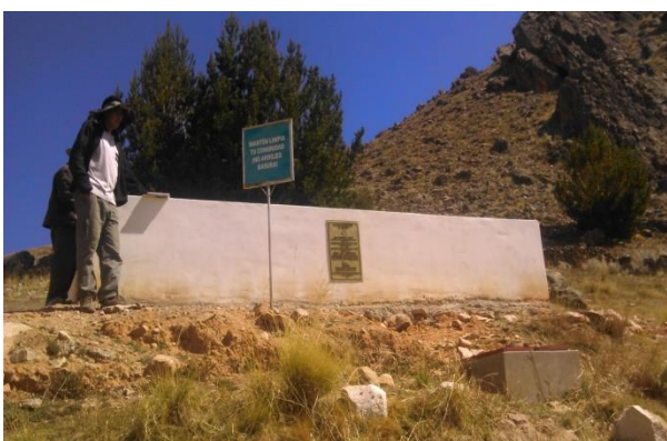
TANQUE DE ALMACENAMIENTO (36 M3)
