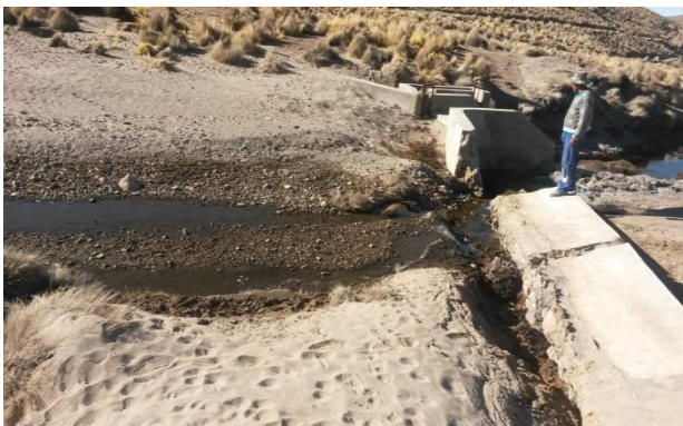
OBRA DE TOMA DESTRUIDA
