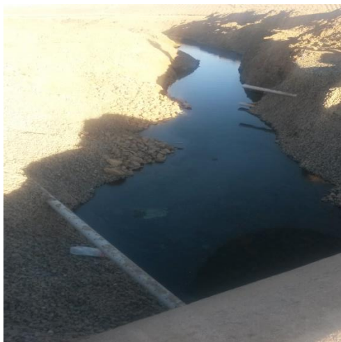
TOMA DE AGUA (GALERIA FILTRANTE)
