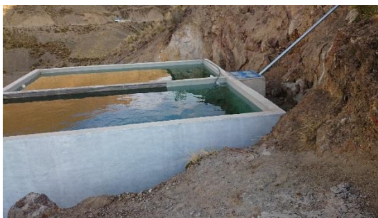
TANQUE DE ALMACENAMIENTO (150 M3)
