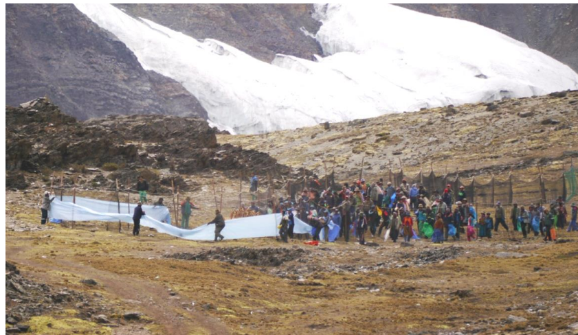
Instalación de Mangas de captura
